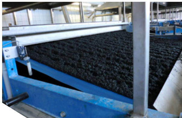
Рис. 5-6: Ленточный фильтр-пресс на очистных сооружениях в Щецине (Польша). Фото: ZWiK Szczecin
