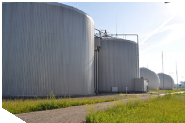
Рис. 7-4: Метантенки и газгольдеры, очистные сооружения «Поможаны», Щецин (Польша). Фото: ZWiK Szczecin
