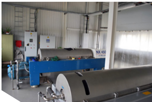
Рис. 5-9: Центрифуга и барабанный уплотнитель, очистные сооружения Юрмалы. Фото: PIU Jūrmalas ūdens
