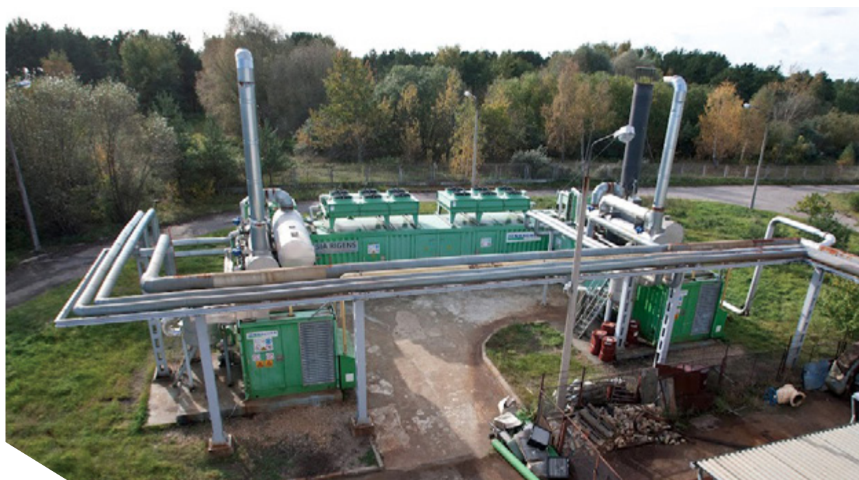
Рис. 4-9: Энергоцентральный с ТЭЦ, газовым факелом и системой нагрева в Риге (Латвия). Фото: SIA Rīgas ūdens
