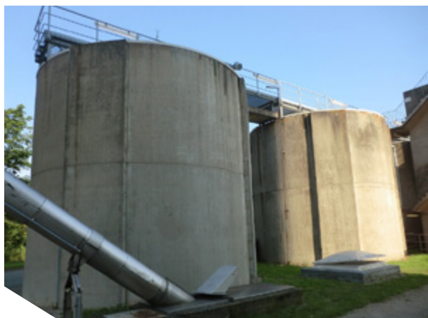
Рис. 3-2: Гравитационный илоуплотнитель в Любеке (Германия). Фото: Entsorgungsbetriebe Lübeck
