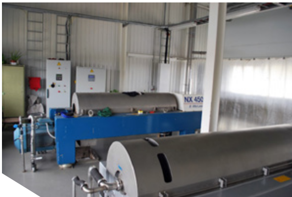
Ilustracja 5-9: Wirówka i zagęszczacz bębnowy, oczyszczalnia ścieków Sloka, Łotwa. Zdjęcia: PIU Jurmalas Udens.
