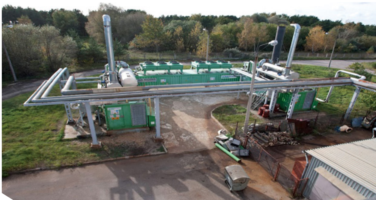
Ilustracja 4-9: Centrala energetyczna w obiekcie CHP wyposażona w pochodnię gazową i system ogrzewania (Ryga, Łotwa). Zdjęcie: SIA Rigas Udens.
