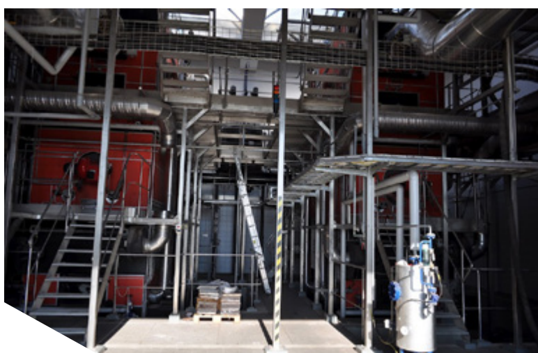
Ilustracja 7-3: Instalacje do suszenia i spalania osadów w Szczecinie (Polska), Zdjęcie: ZWIK Szczecin.
