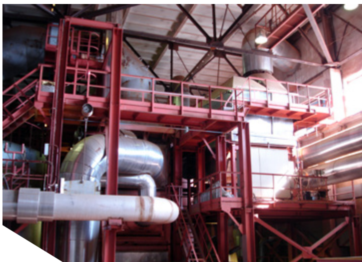
Ilustracja 8-2: Spalarnia w St. Petersburgu Zdjęcie: Lotta Ruokanen, HELCOM.
