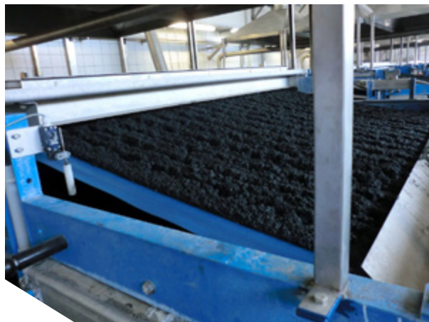
Ilustracja 5- 6: Osady ściekowe na taśmowej prasie filtracyjnej w Szczecinie. Zdjęcie: ZWIK Szczecin.
