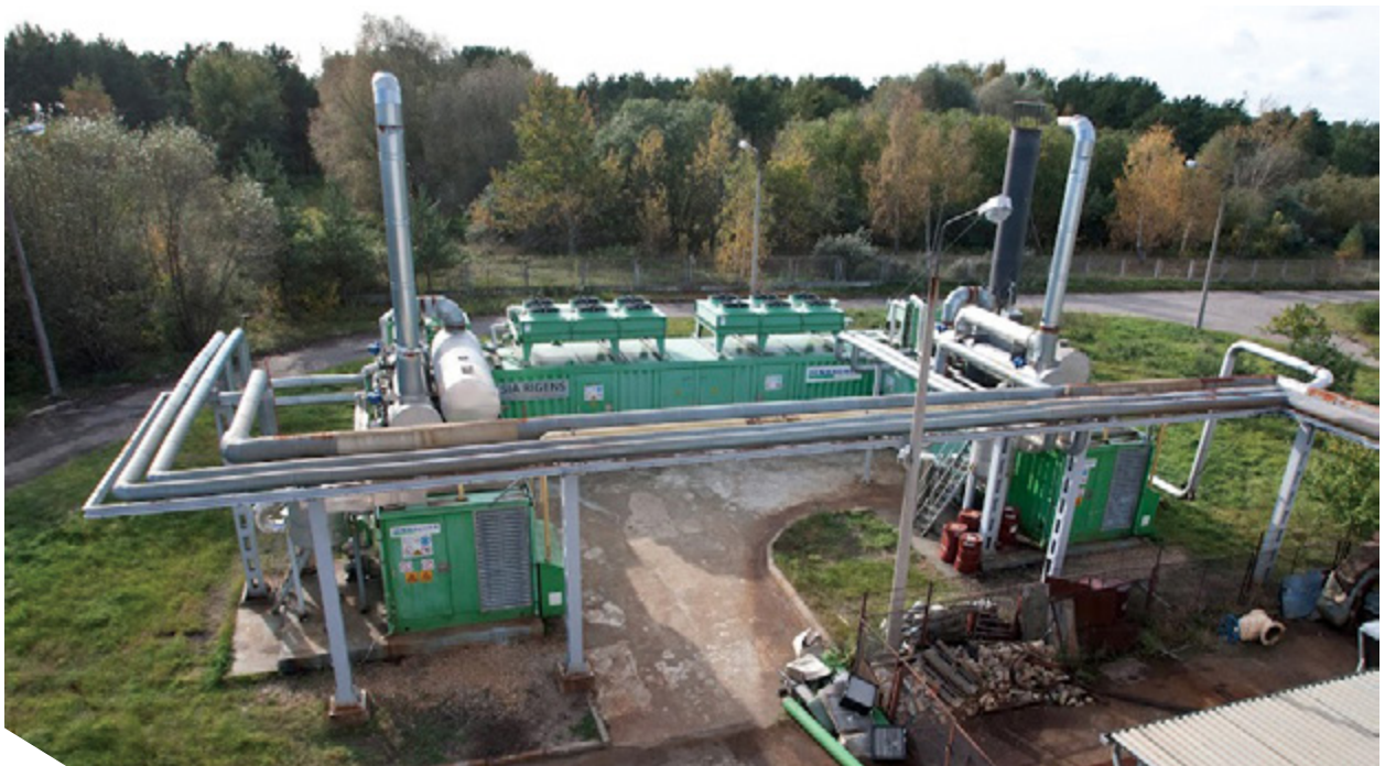
Abbildung 4-9: Energiezentrale mit BHKW, Gasfackel und Heizsystem in Riga, Lettland. Foto: SIA Rigas Udens.
