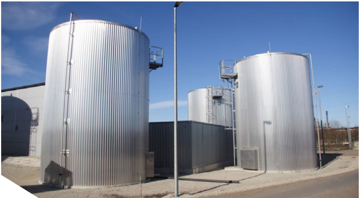
Abbildung 6-2: Pasteurisierungsanlage in Kohtla-Järve, Estland. Foto: OÜ Järve Biopuhastus.
