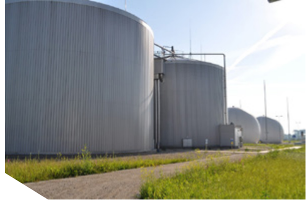
Abbildung 7-4: Faulbehälter und Gastanks, Kläranlage Pomorzany in Stettin, Polen. Foto: ZWiK Szczecin.
