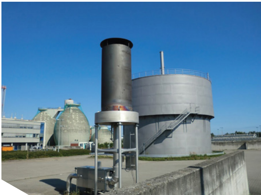
Abbildung 4-6: Gasfackel, Gasspeicher und Faulbehälter in Lübeck, Deutschland. Foto: Entsorgungsbetriebe Lübeck.
