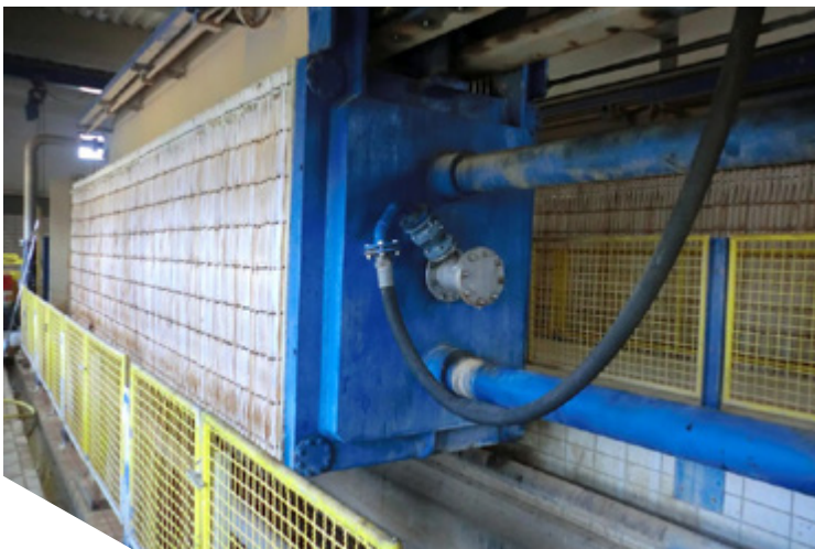
Abbildung 5-7: Kammerfilterpresse in Lübeck, Deutschland. Foto: Entsorgungsbetriebe Lübeck.
