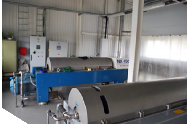
Abbildung 5-9: Zentrifuge und Trommeleindicker, Kläranlage Jurmala, Lettland. Fotos: PIU Jurmalas Udens.
