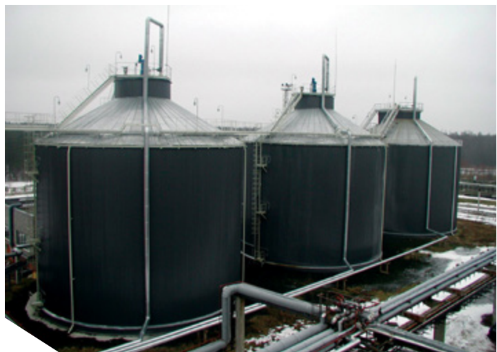
Abbildung 4-2: Verschiedene Formen von Faulbehältern in Lübeck, Deutschland, und Riga, Lettland. Fotos: Entsorgungsbetriebe Lübeck und SIA Riga Udens.
