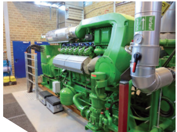
Abbildung 4-8: Blockheizkraftwerke in Stettin, Polen, und Lübeck, Deutschland. Fotos: ZWIK Szczecin und Entsorgungsbetriebe Lübeck.
